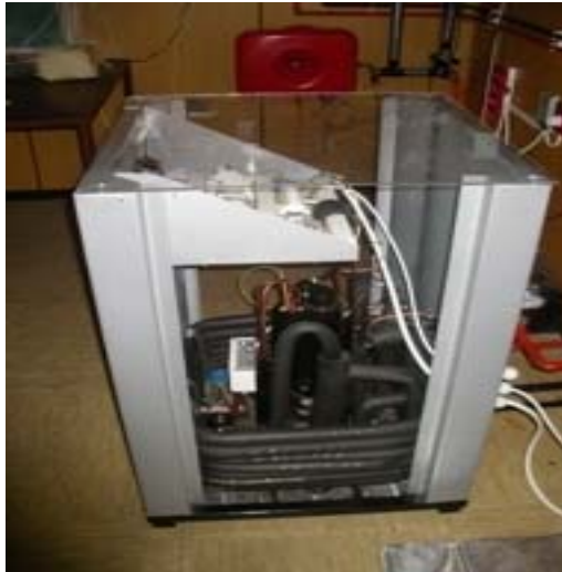
Слика 2 Топлотна пумпа
