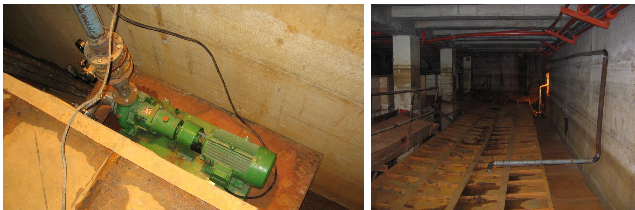
Slika 8 Ugrađena pumpa na cirkulacionom vodu, Detalji rezervoara (jame) ESK1
