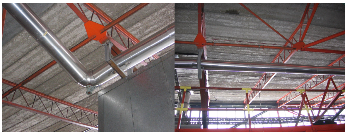
Slika 6 Izolovanje parovoda na liniji 4
