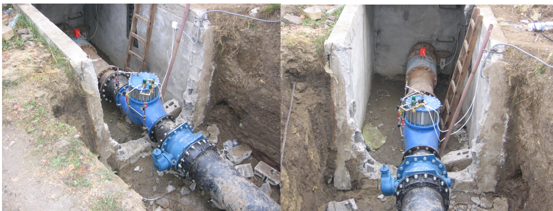
Slika 7 Detalji ugradnje programabilnog regulatora pritiska
