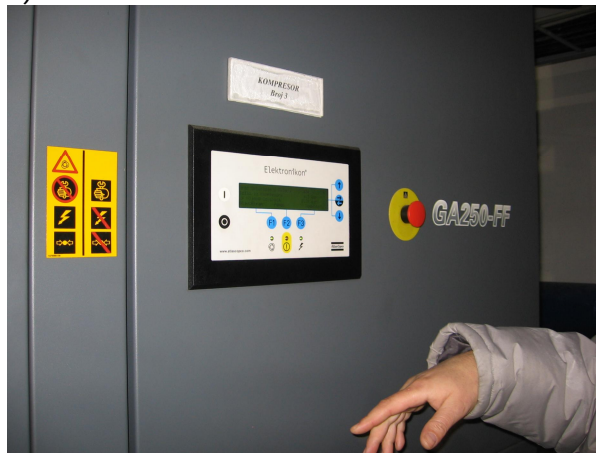
Слика 3. Деталји уграђене компресорске станице КС-1 а) компресор, б) контролно-управљачка табла, ц) детаљ вијчаног компресора
